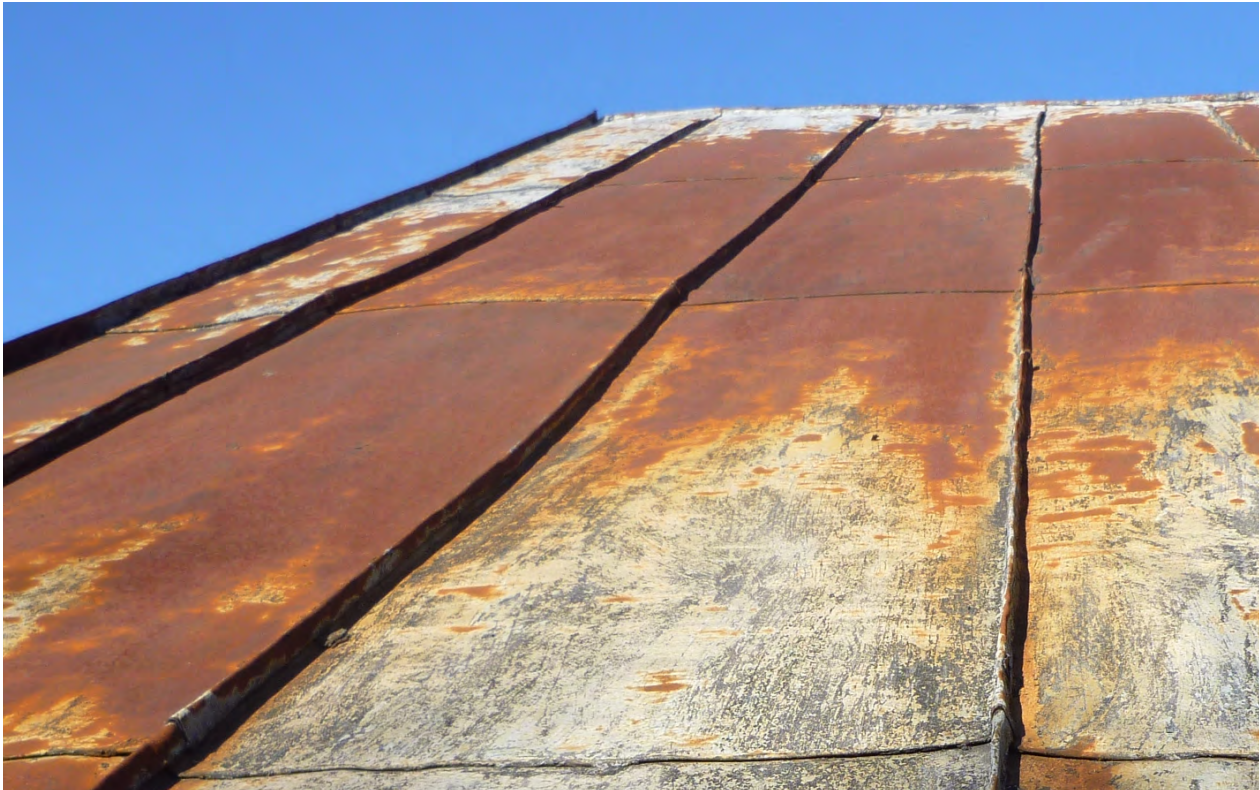
Kuva 17: Pahasti ruostunut vanha peltikate. Kattoa ei tulisi päästää näin pahaan kuntoon. Pelti on tarpeeksi paksua, joten tämäkin katto on vielä korjattavissa, jos se ei ole ruostunut puhki.
