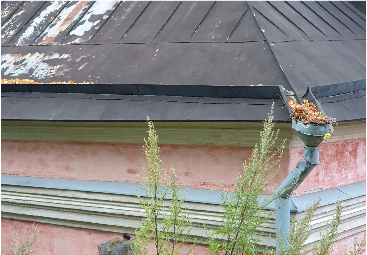
Kuva 15: Katot ja sadevesijärjestelmät tulee puhdistaa säännöllisesti, sillä peltikaton kerääntyneet roskat ja lehdet voivat tukkia vedenpoiston ja käynnistää korroosion.
