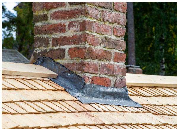
Kuva 25: Muurattu savupiippu on pellitetty lyijypellillä, joka on kiinnitetty ruuveilla ja bitumiliimalla.
