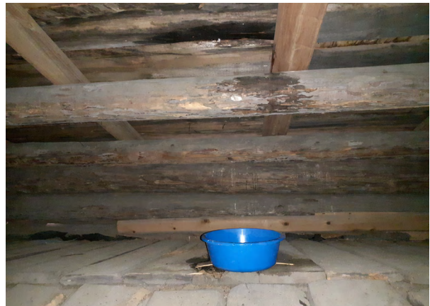
Kuva 9: Vuotokohdan löytää helpoiten yläpohjan puo- lelta. Aluskafeen tummuminen kertoo kosteusrasituk- sesta.
